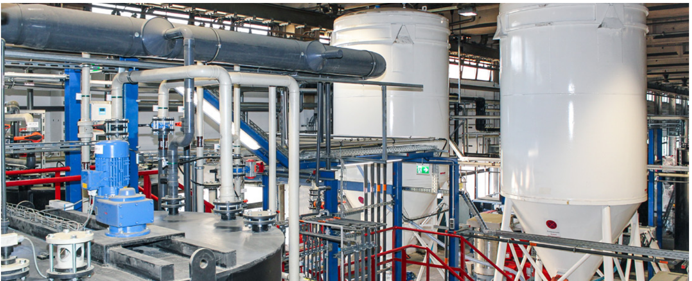
Bild 9 – Multifunktionale Anlage zur Metallabtrennung, errichtet durch die Umwelt- und Ingenieurtechnik GmbH Dresden
